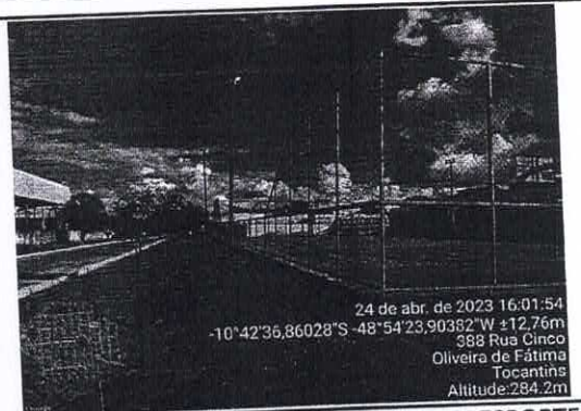
FOTO 04 - ALAMBRADO DA QUADRA DE ESPORTE
