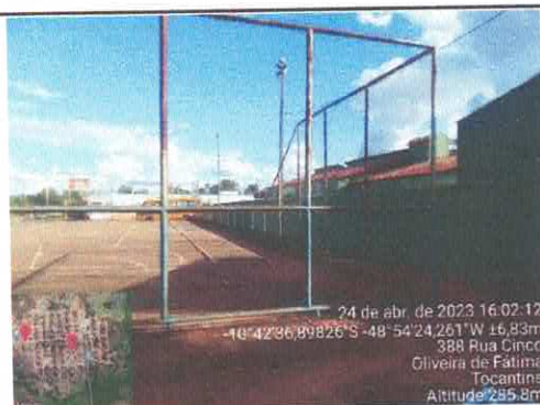
FOTO 03 - ALAMBRADO DA QUADRA DE ESPORTE
