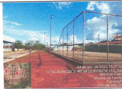
FOTO 04 - ALAMBRADO DA QUADRA DE ESPORTE
