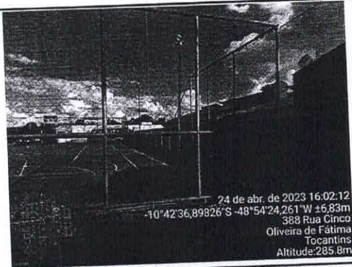
FOTO 03 - ALAMBRADO DA QUADRA DE ESPORTE
