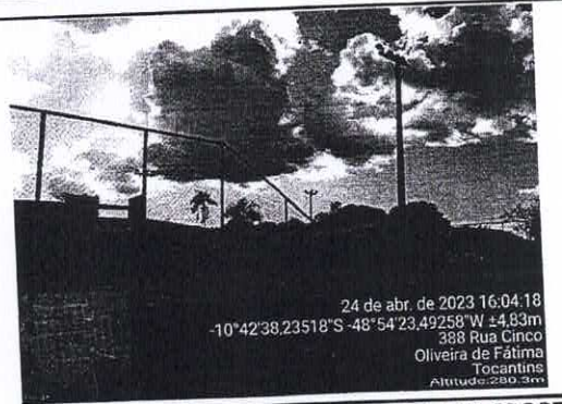
FOTO 06 - ALAMBRADO DA QUADRA DE ESPORTE
