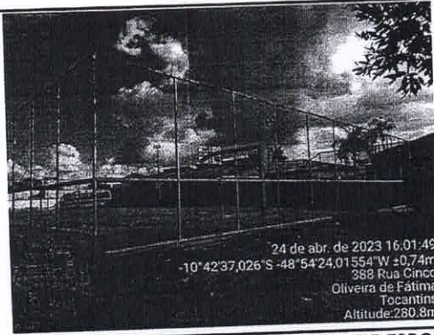
FOTO 01 - ALAMBRADO DA QUADRA DE ESPORTE
