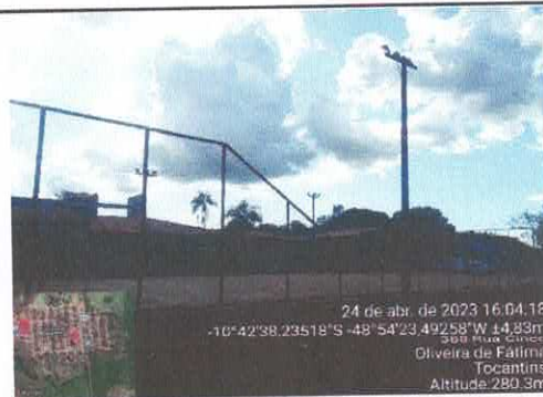
FOTO 06 - ALAMBRADO DA QUADRA DE ESPORTE
