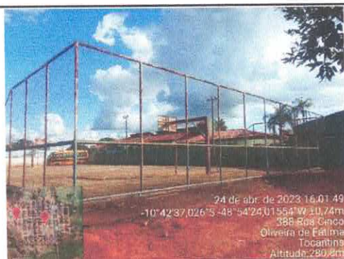
FOTO 01 - ALAMBRADO DA QUADRA DE ESPORTE
